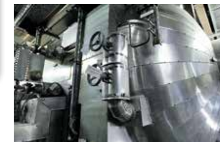
Die Dampftrommel transportiert den Dampf zur Turbine
